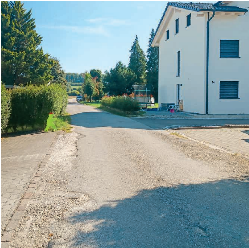
Noch präsentiert sich der Cholerweg in einem desolaten Zustand
